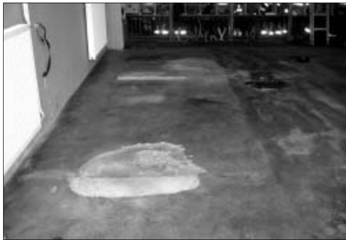
Poškodovan tlak, ki ga bo treba popraviti. (Foto: arhiv PGD Trzin)
